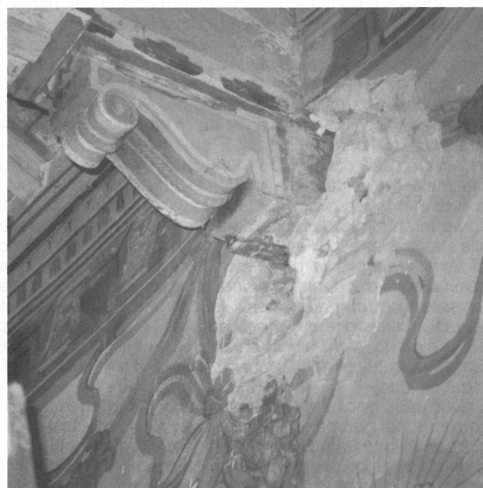
FOTO 3 Mensola della capriata pericolante: è evidente lo sfilamento dal muro.
